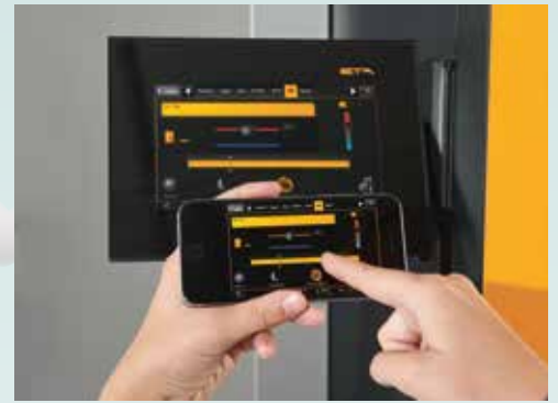
La chaudière se laisse régler par Smartphone, PC ou tablette, voire directement par l'intermédiaire de l'écran tactile.
